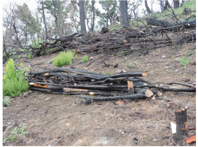
Détails de travaux de fascinage réalisés avec les matériaux du site - Les travaux de restauration ont été rendus possibles grâce à un financement à hauteur de 80% apporté par la Région Sud et le Département du Var. En complément, un financeur privé, le ROTARACT, a permis la réalisation d'un chantier supplémentaire à Cogolin, financé à 100% ©ASL Suberaie Varoise
